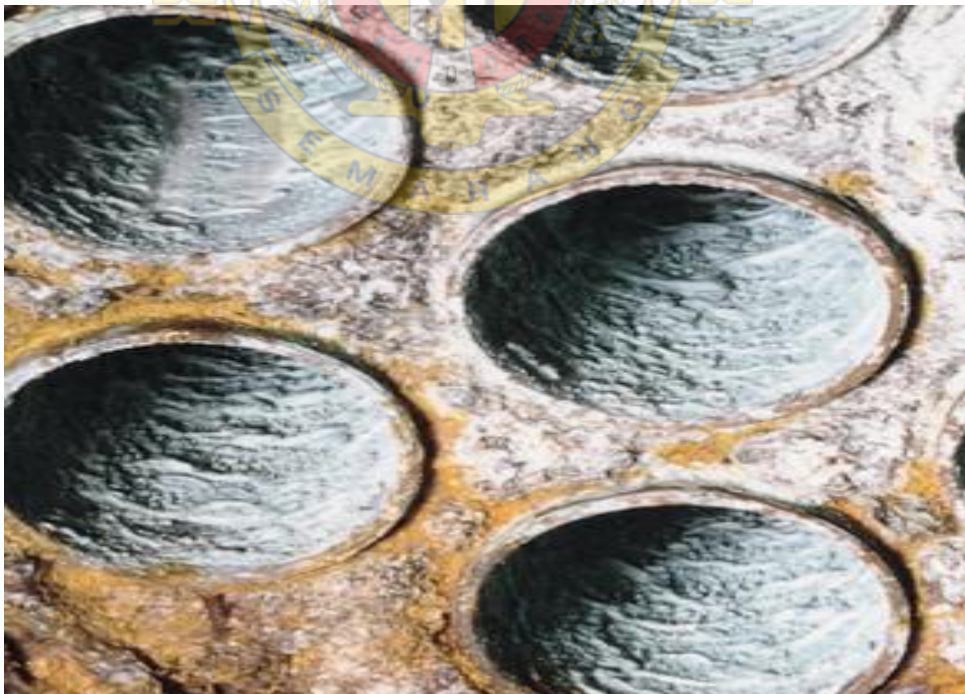
Gambar korosi pada pipa air pendingin
