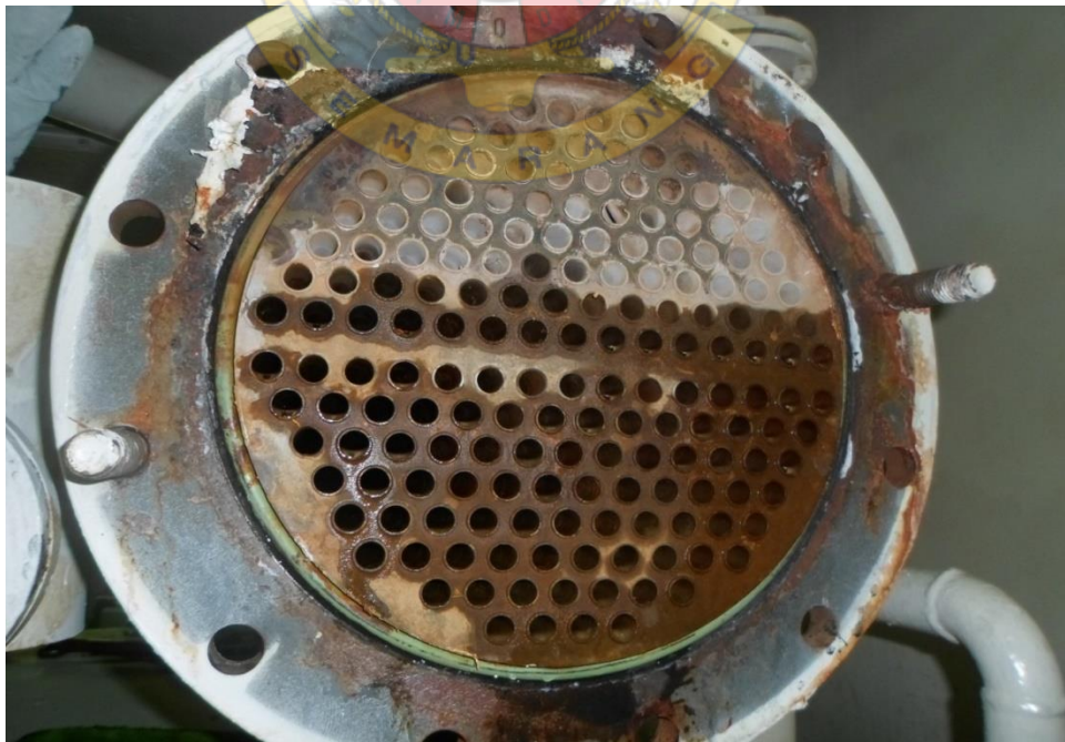
Gambar pergantian rubber gasket antara ruang air laut dengan ruang uap pada sambungan cover.
