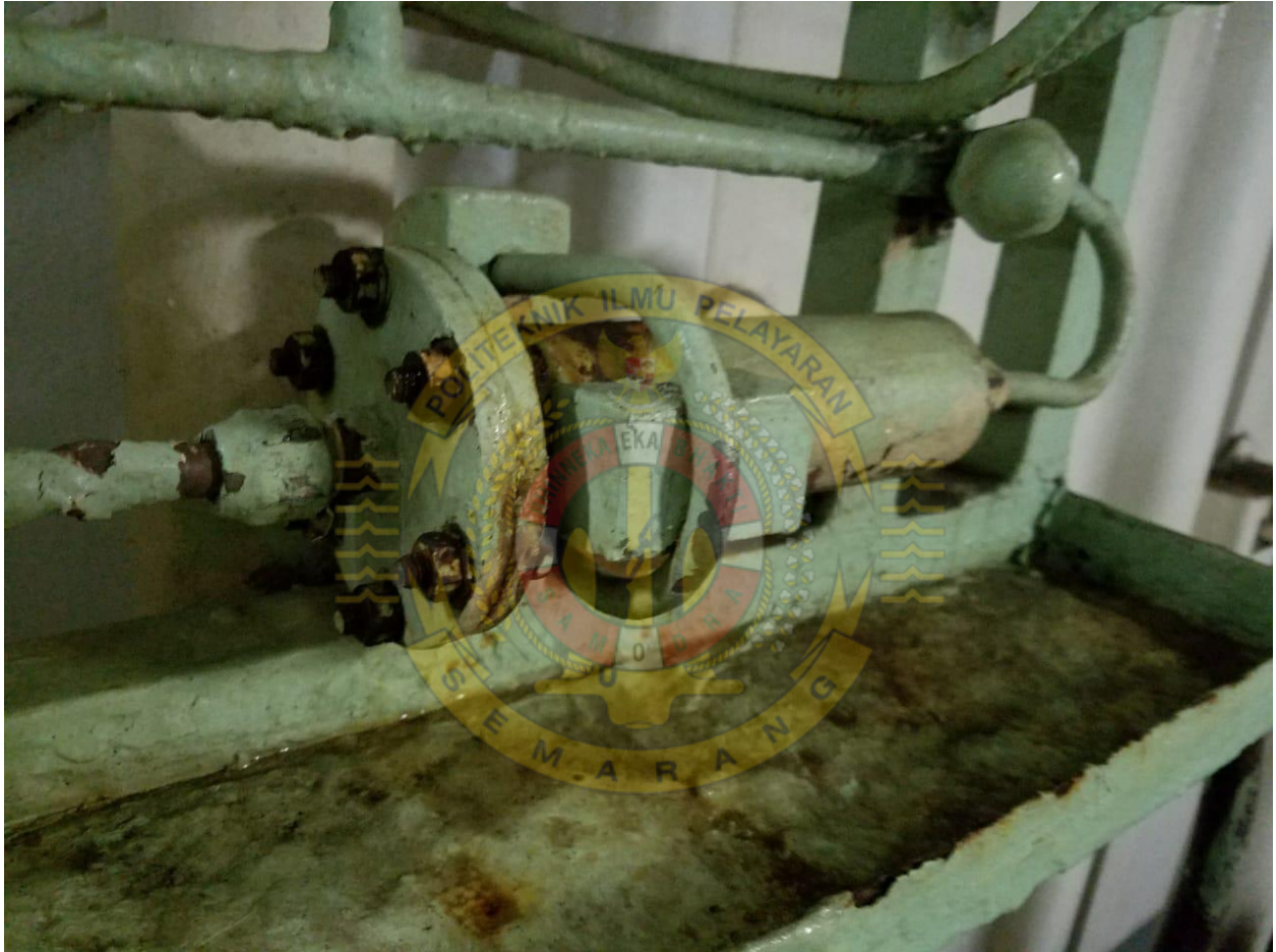
Gambar filter Dryer di MT. Celosia
