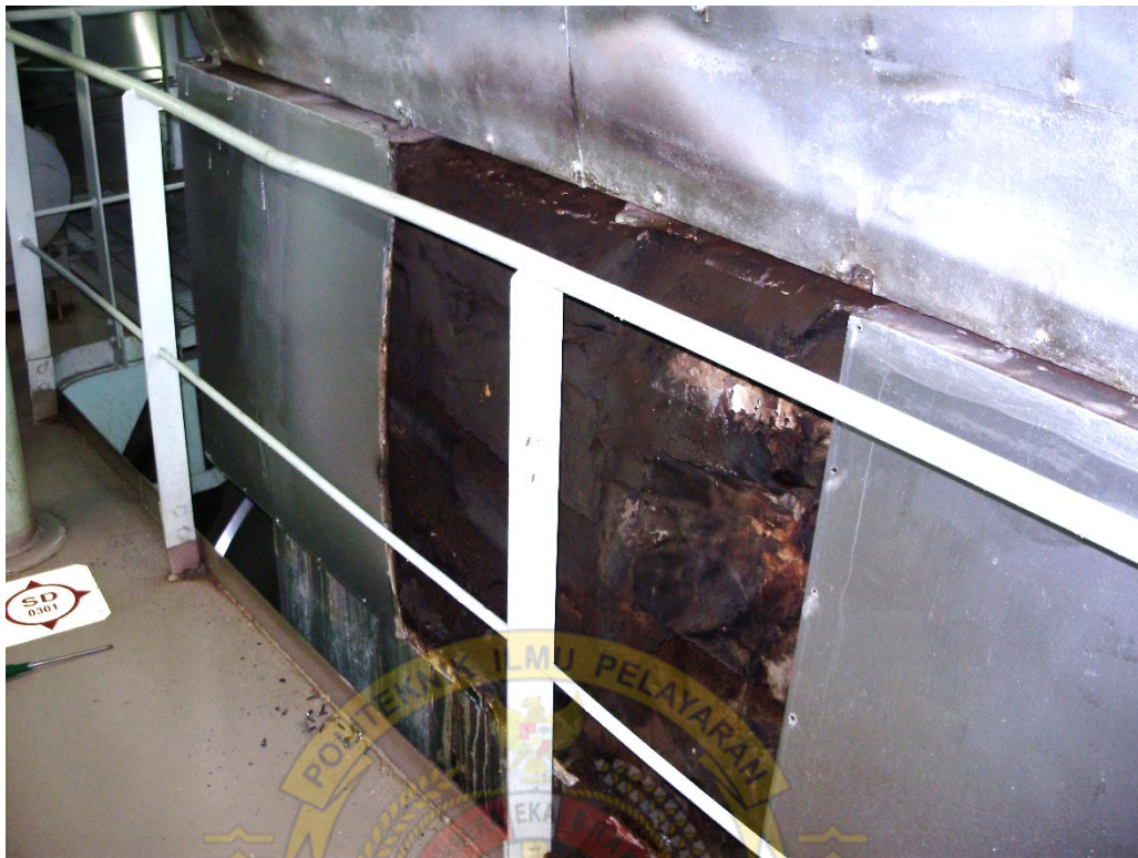
Kerusakan pada insulator panas dari EGE
