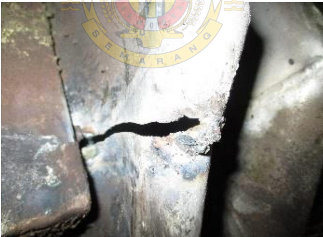
Kerusakan pada cover dari EGE
