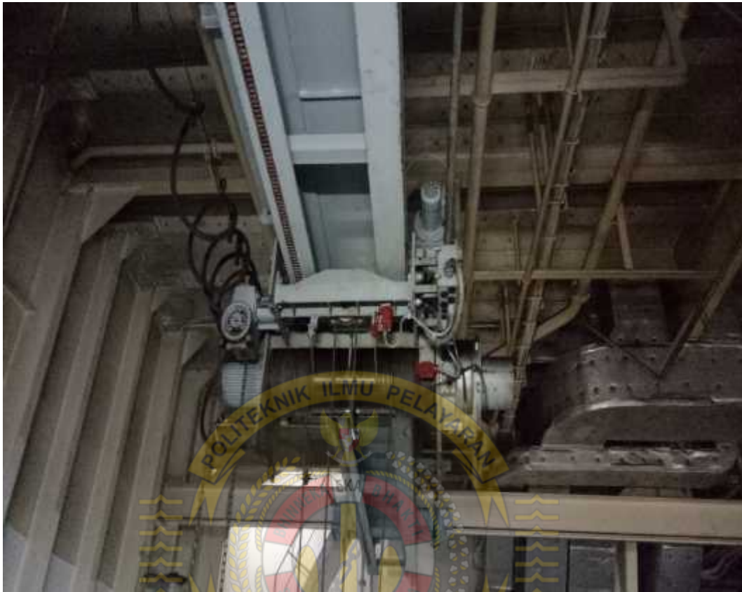
Gambar Mesin Crane didalam kamar mesin.
