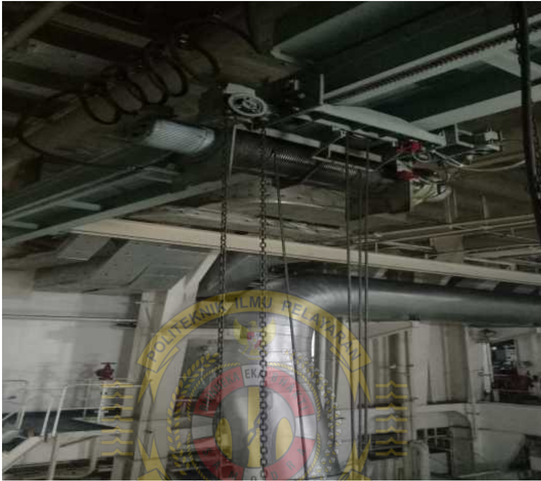
Gambar Mesin Crane didalam kamar mesin.
