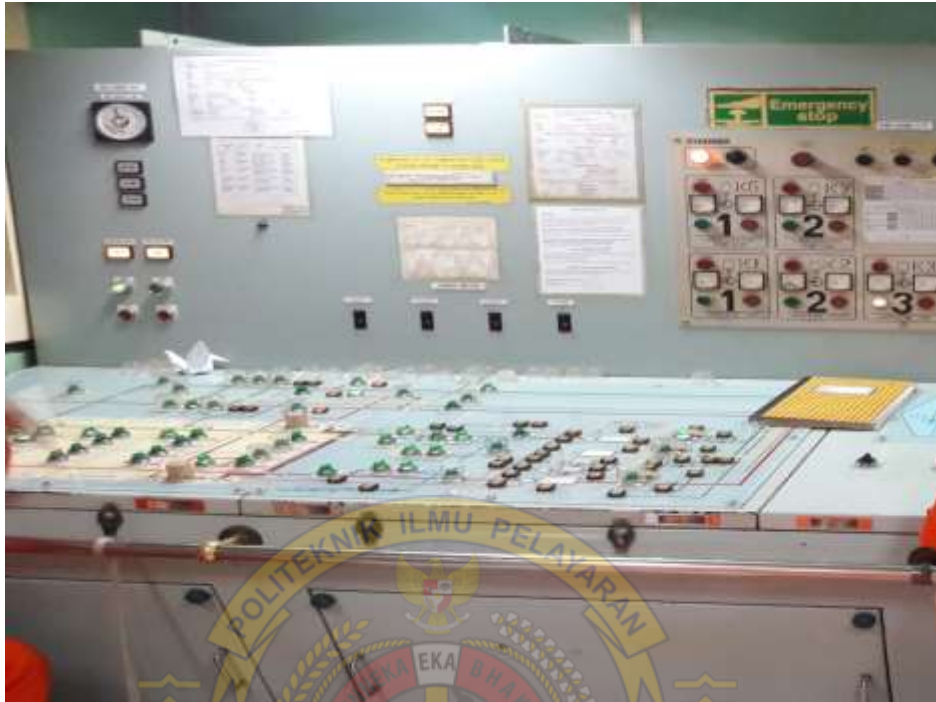
Gambar 1. Cargo Control Panel yang terletak di CCR ( Cargo Control Room) kapal MT. Sinar Jogya
