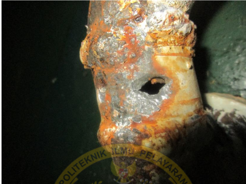
Gambar korosi pada pipa high pressure stering gear.
