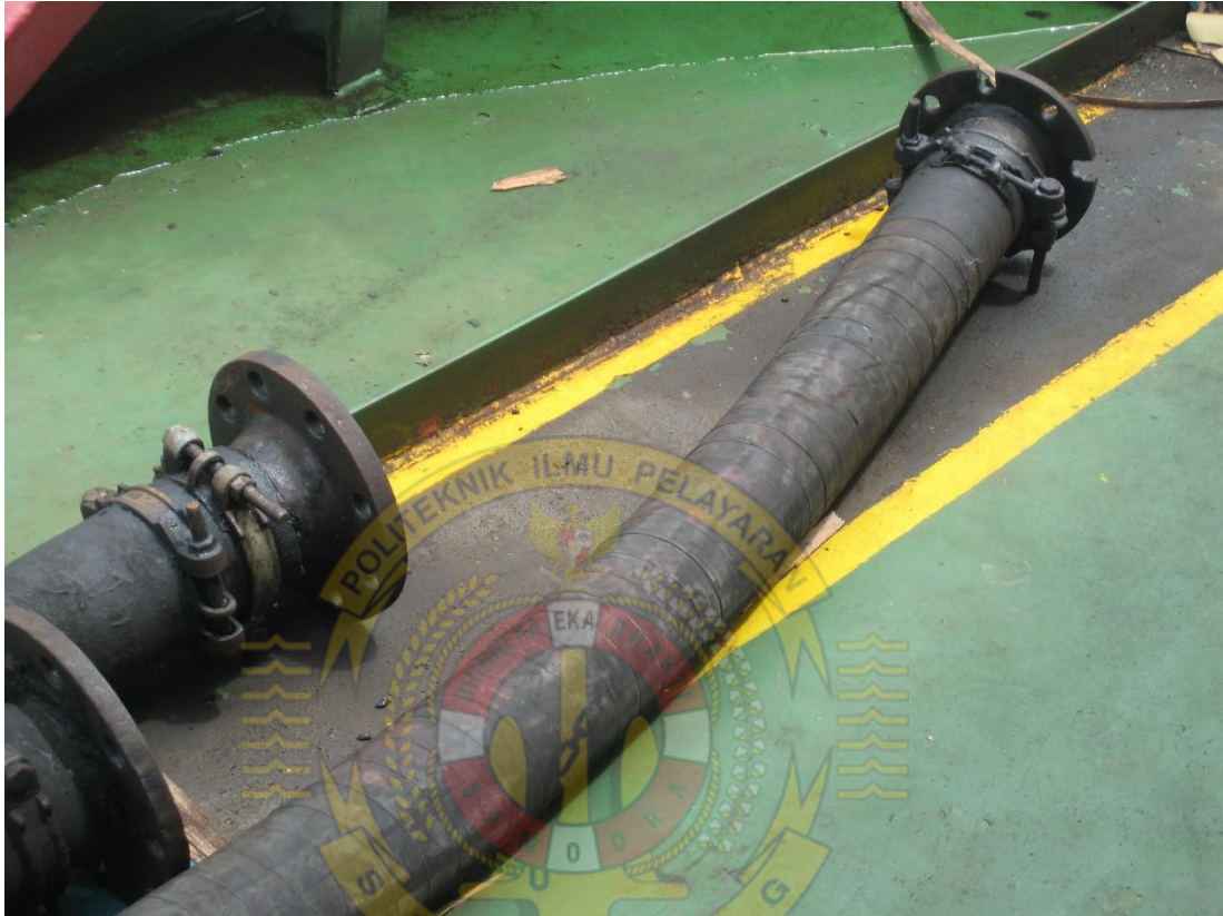
Cargo transfer hose yang rusak
