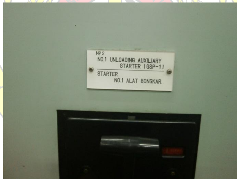
Breaker panel starter alat bongkar nomor 1 pada MSB
