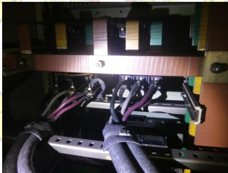
Kabel dari panel shore connection ke MSB Sumber: Dokumen Perusahaan
