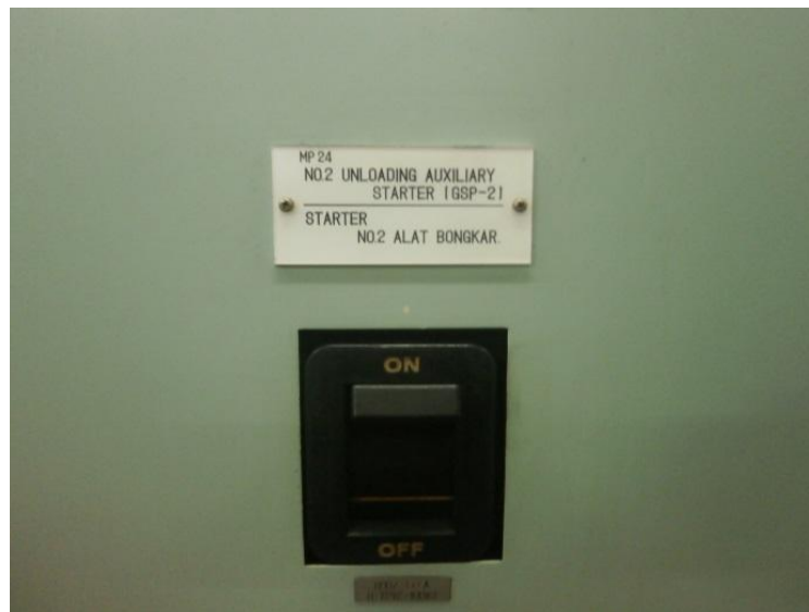
Breaker panel starter alat bongkar nomor 2 pada MSB Sumber: Dokumen Perusahaan
