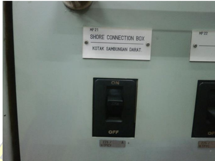
Shore connection box pada MSB
