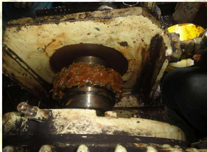
Pelumasan grease pada chain coupling deck crane
