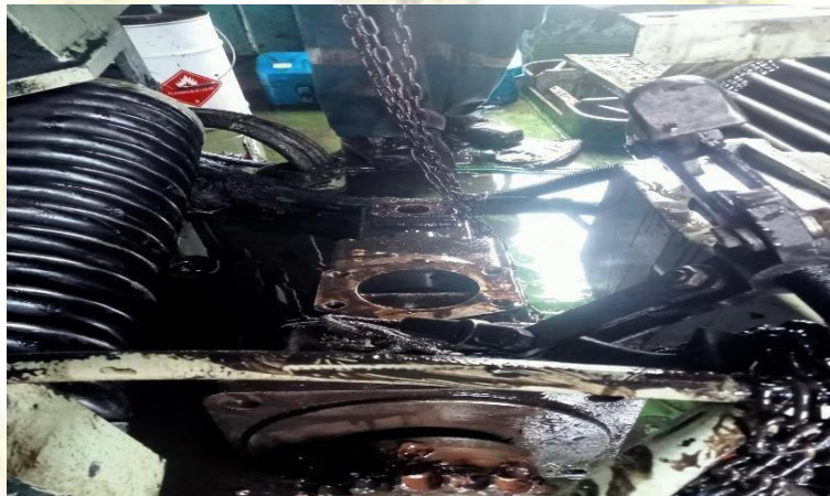
Pompa hidrolik terlepas
