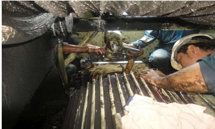
Pelepasan pompa hidrolik
