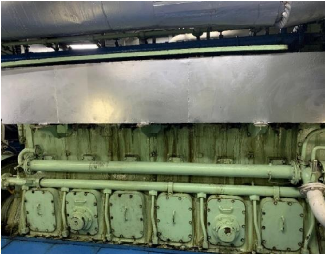
Gambar 2.2. Tampak belakang mesin induk
