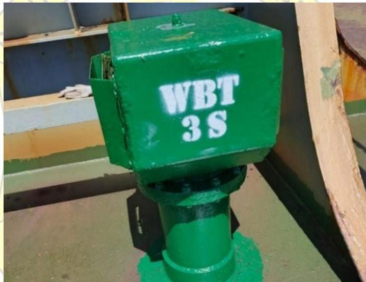
Gambar 2.4 Air vent head Sumber: Dokumentasi peneliti, 2024
