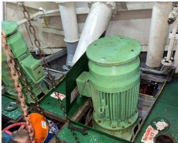
Gambar 2.6 Pompa ballast Sumber: Dokumentasi peneliti, 2024
