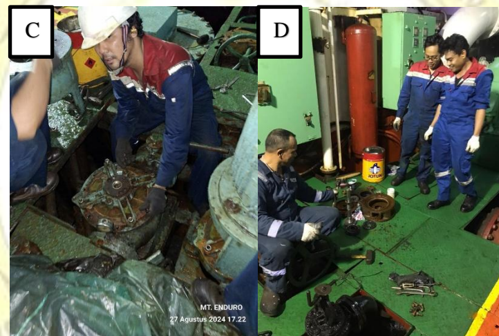
Gambar 5. 1. C. Pemeriksaan pompa D. pemeriksaan bagian-bagian pompa
