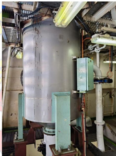
Gambar 2. 3 Scrubber Tower Sumber: Dokumen Pribadi 2024
