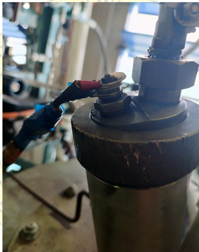
Gambar 4. 30. Kondisi Kabel Ignition Glow Plug
