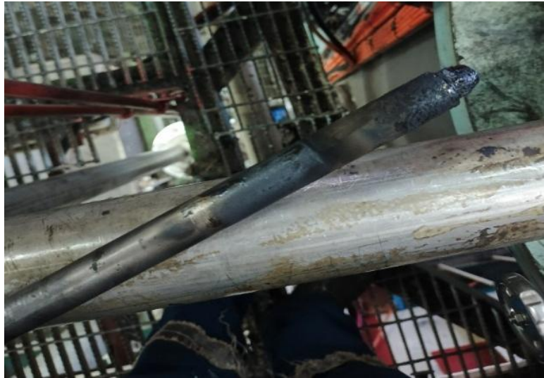
Gambar 4. 26. Kondisi Main Burner Sebelum Dibersihkan
