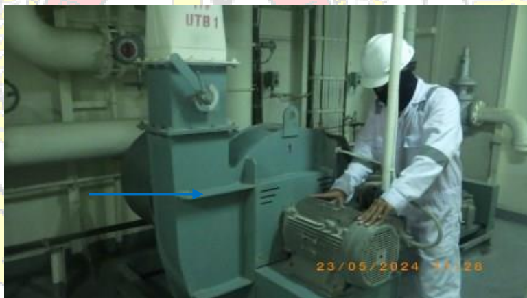
Gambar 2. 5 Unloading Turbo Blower Sumber: Dokumen Penelitian (2024)
