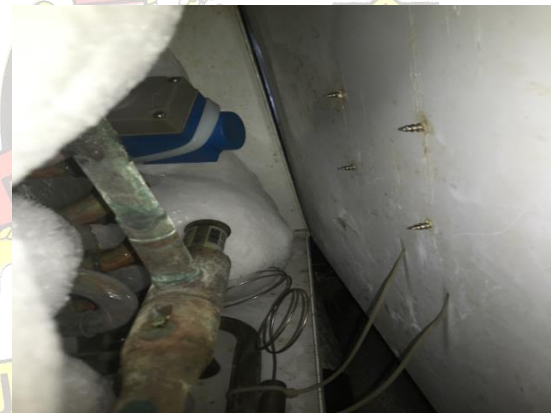
Gambar 4 Tampak bunga es dari sisi samping kanan evaporator
