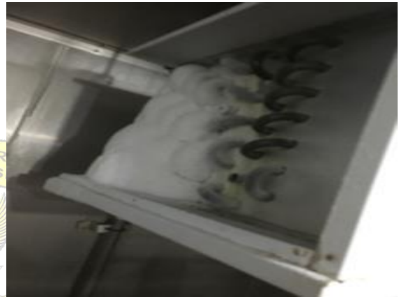
Gambar 2 Tampak bunga es dari sisi samping kanan evaporator
