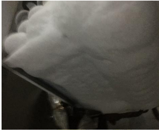
Gambar 1 Tampak bunga es dari sisi belakang evaporator
