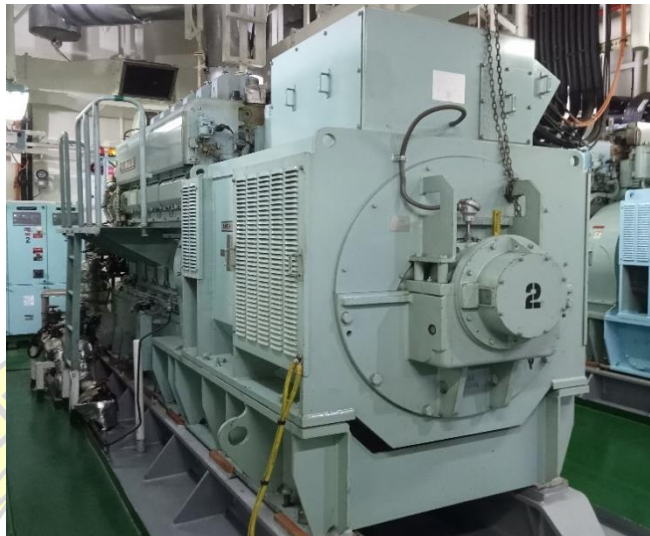
Gambar 2. 1 Diesel Generator di MV. Pan Epic.
