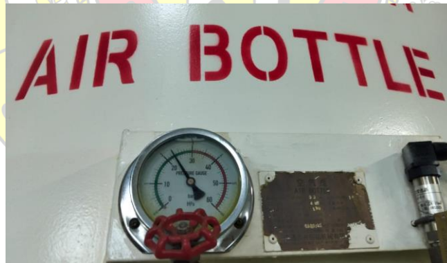
Gambar 2. 4 Tekanan udara pada main air reservoir tank .
