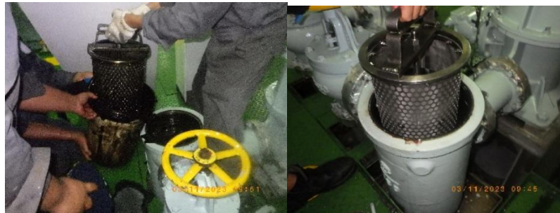
Gambar 4. 15 Gambar filter sebelum dan sesudah dibersihkan Sumber: Dokumentasi pribadi
