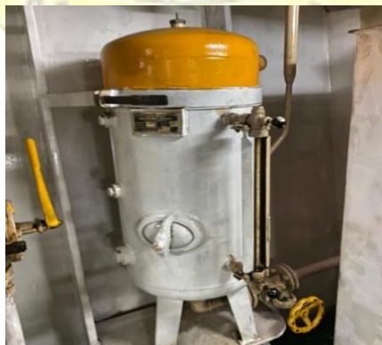
Gambar 2. 3 Reservoir tank Sumber : Dokumentasi Pribadi
