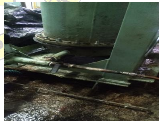
Gambar 16. Bottom off Valves yang dimodifikasi untuk sirkulasi dengan air pressure
