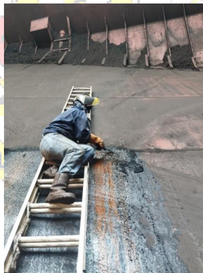
Gambar 1. 1 kebocoran diruang palka 6 sisi kiri
