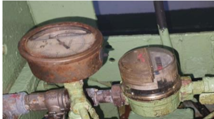
Gambar 2. 7 Flow Meter Sumber : Dokumentasi Peneliti
