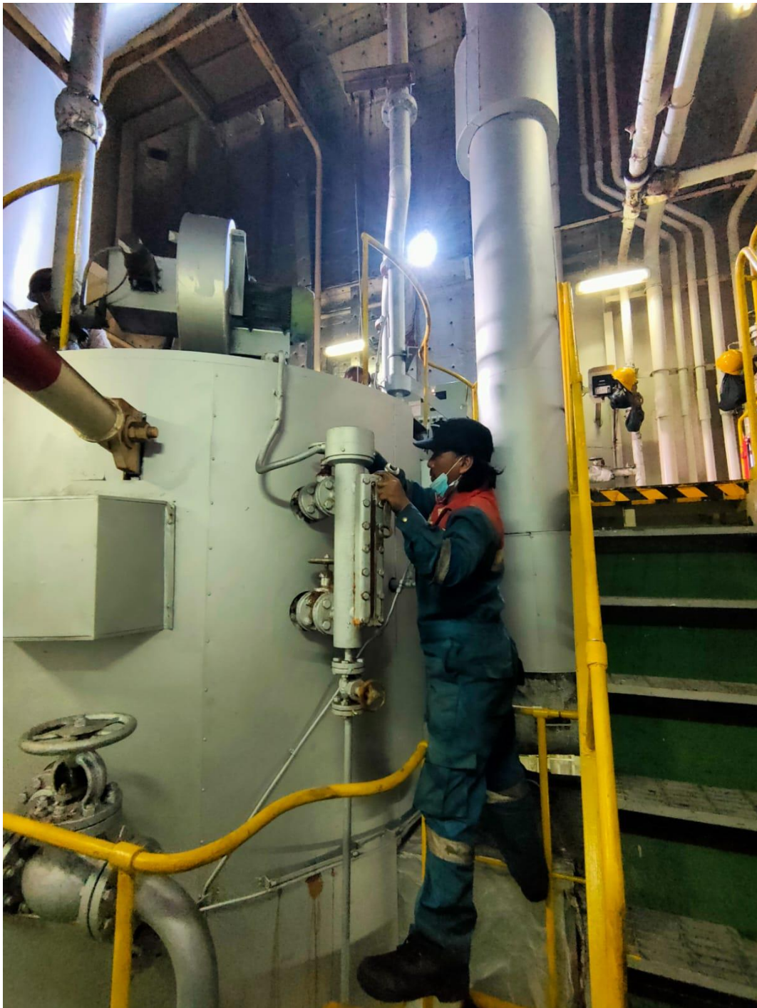
Lampiran 8 Boiler pada MV. Arimbi Baruna
