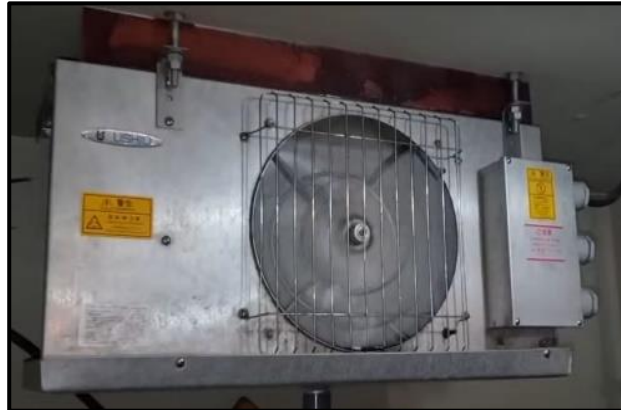
Gambar 2. 6 Evaporator Sumber: Dokumentasi peneliti 2022
