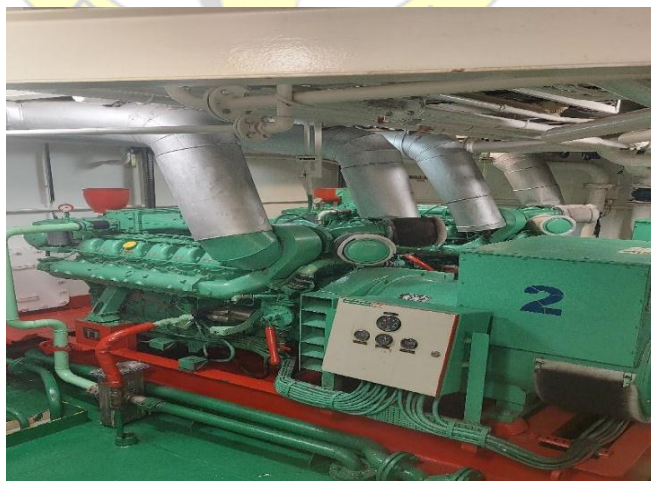
Gambar 2. 3 Diesel Generator di MV. Francisca
