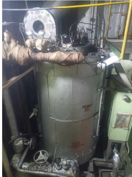
Gambar 2.1 Thermal Oil Boiler Sumber: Dokumentasi pribadi (2022)
