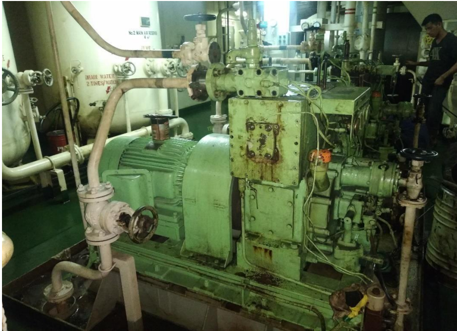
Gambar : Kondisi Kompresor Udara Sumber : Dokumentasi Penelitian, 2023
