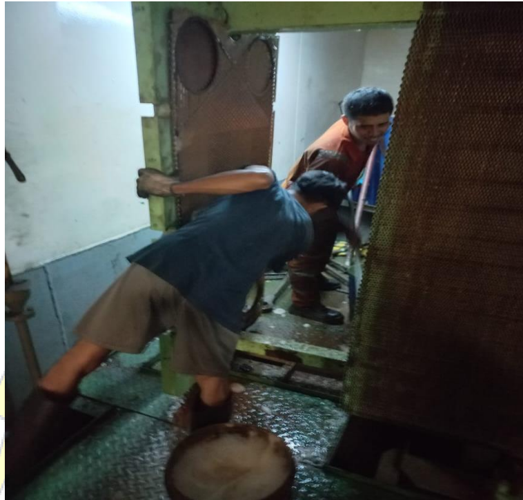
Gambar 6.1 pembersihan pelat fresh water cooler Sumber : Dokumen kapal
