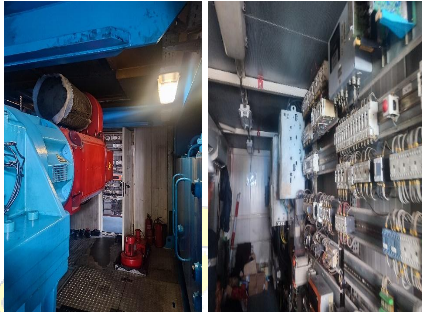
Gambar 2. 4 Ruang Mesin Sumber : Dokumentasi pribadi
