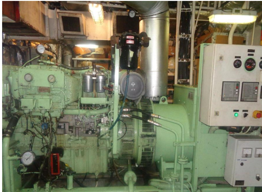
Gambar 2.2. Mesin Diesel Generator di MV.Tembaga sea Sumber : Dokumentasi pribadi (2023)
