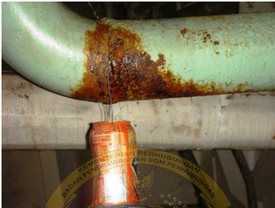
Gambar. 7 Pipa yang bocor karena korosi air laut
