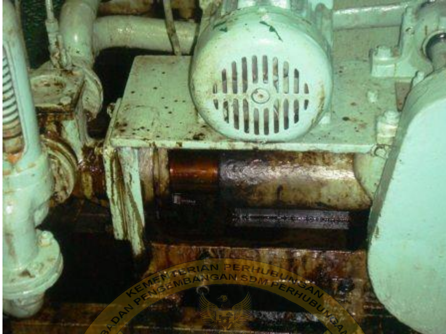
Gambar. 5 pompa bahan bakar yang bocor
