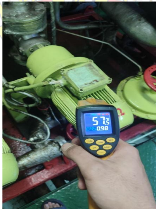
Temperatur FO Booster Pump terlalu tinggi
