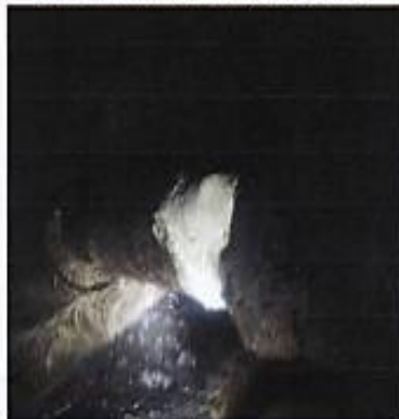
Pemeriksaan Visual Jalur Pipa yang bocor
