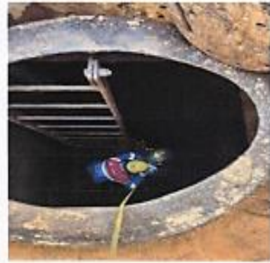
Pemeriksaan Visual Jalur Pipa yang bocor
