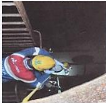
Pemeriksaan Visual Jalur Pipa yang bocor
