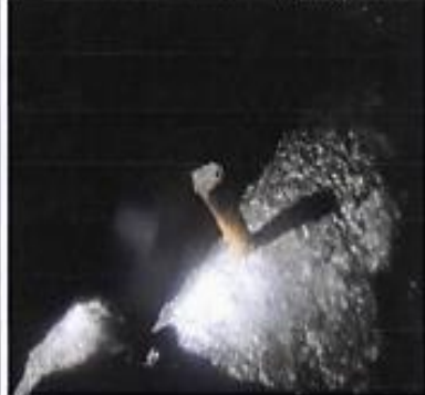
Pemeriksaan Visual Jalur Pipa yang bocor
