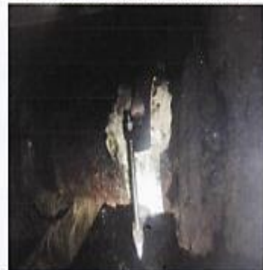
Penanganan Jalur Pipa yang bocor
