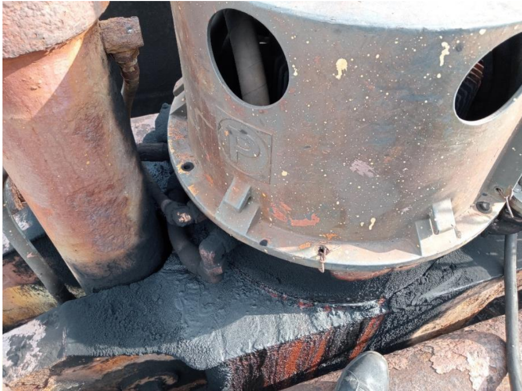
Kebocoran oli di sekitar unit hidrolik floating crane
