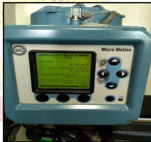
Gambar 2.13 Flow Meter MT. Gebang Sumber : Dokumen Pribadi
