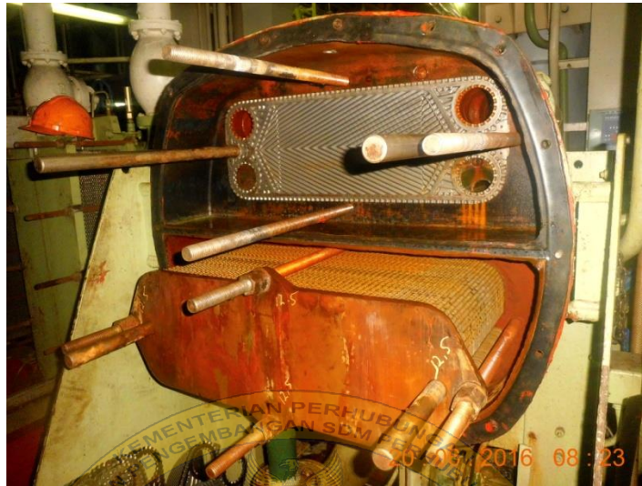
Kondisi Evaporator Pada Fresh Water Generator Sebelum Dilakukan Pembersihan
