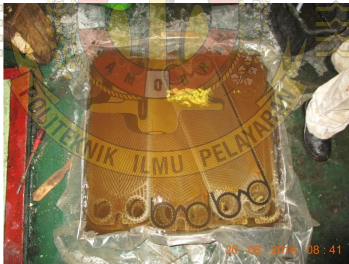
Kondisi Plat Evaporator Sebelum Dilakukan Pembersihan
