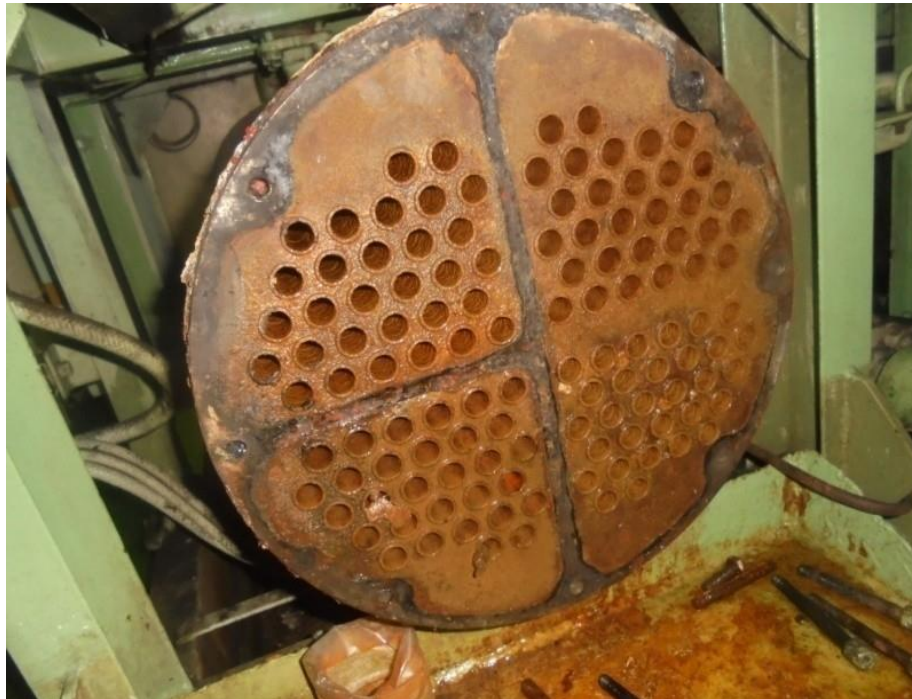
Kondensor sudah bersih
