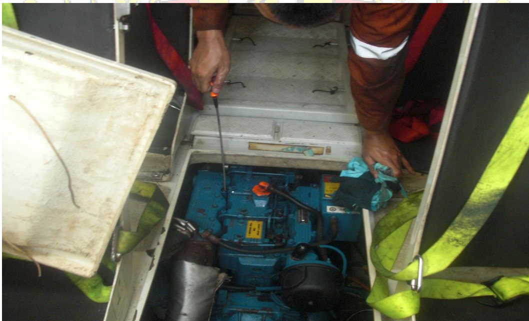
Gambar 6.2 Pengecekan pada seluruh sistem engine lifeboat
