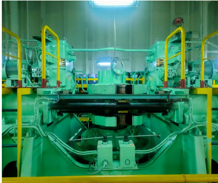
Gambar 2.1 Steering Gear di MV.Manalagi Asta. Sumber: Dokumentasi pribadi 2021
