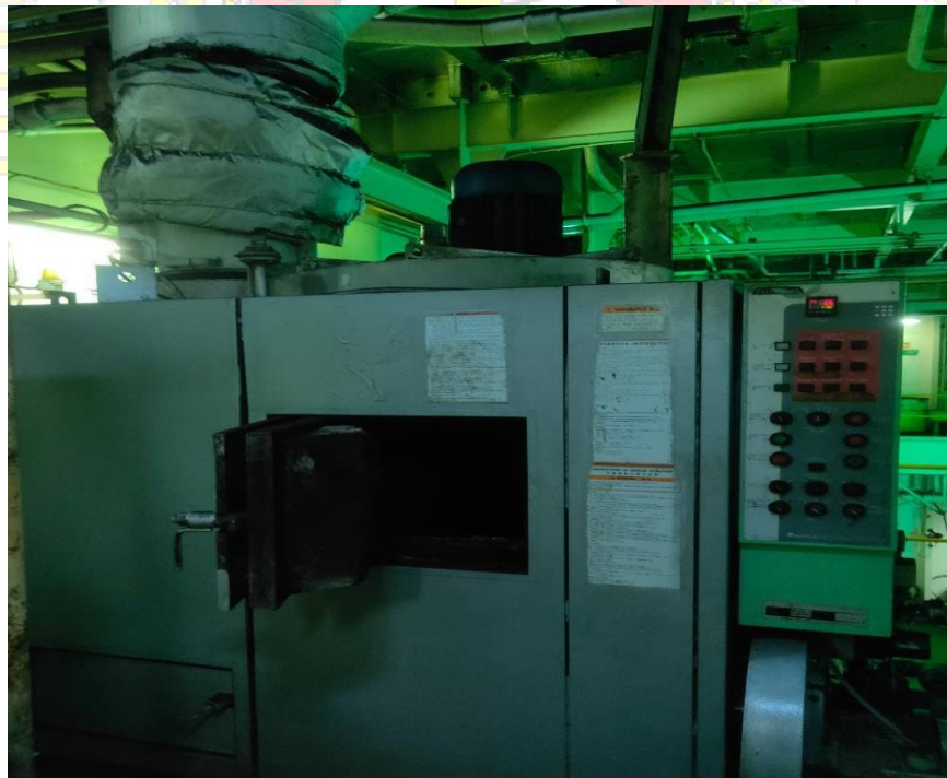
Gambar alat incinerator di kapal
