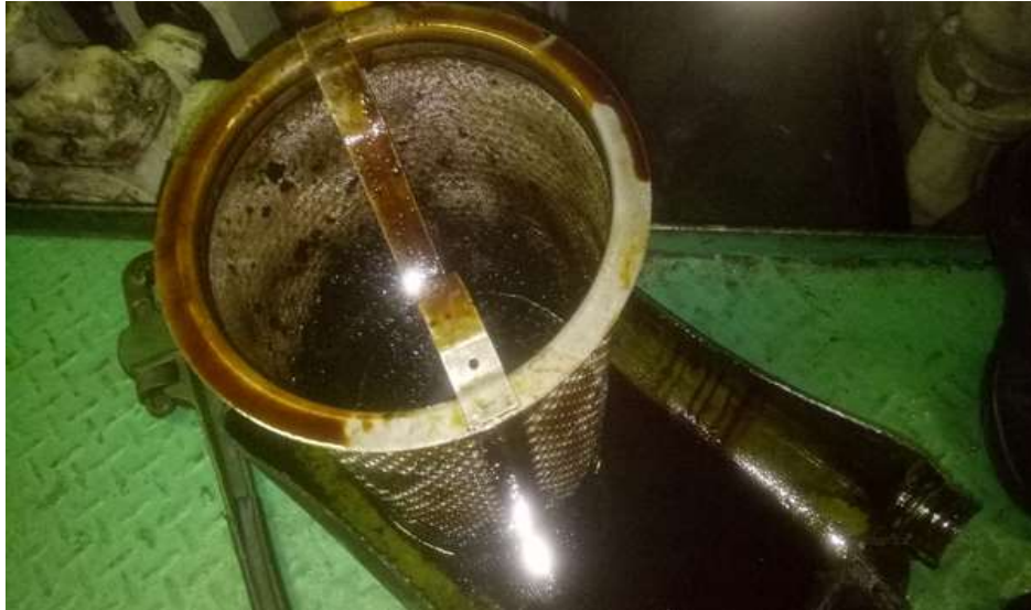
Kondisi Filter Bahan Bakar Sebelum Di Bersihkan
