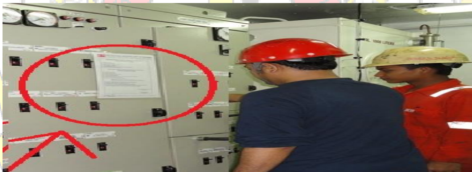
Penempelan Prosedure Pengoperasian pada Panel Main Air Compressor
