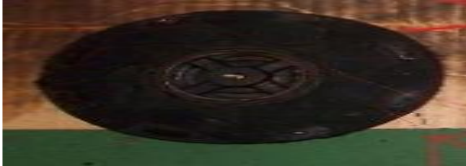
Kondisi Low Pressure Valve Main Air compressor Sumber : Dokumentasi KM. Gunung Dempo (2021)
