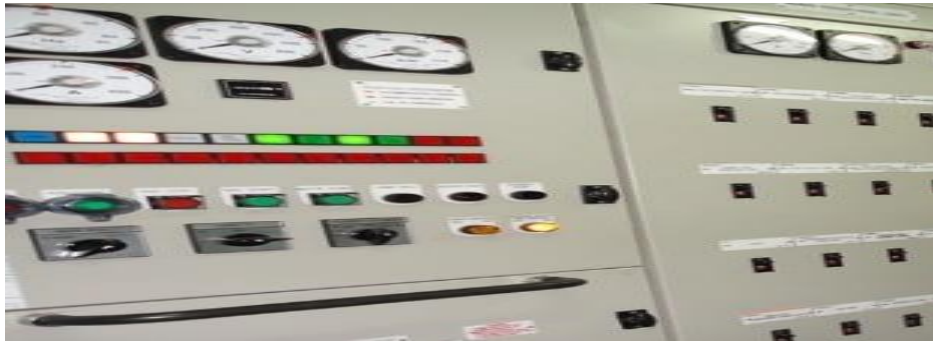
Panel pada Main Air Compressor
