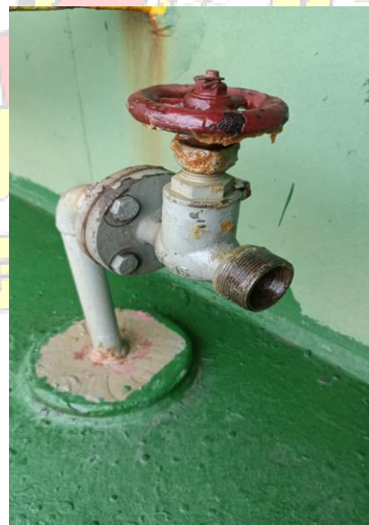
Gambar valves pneumatic di haluan
