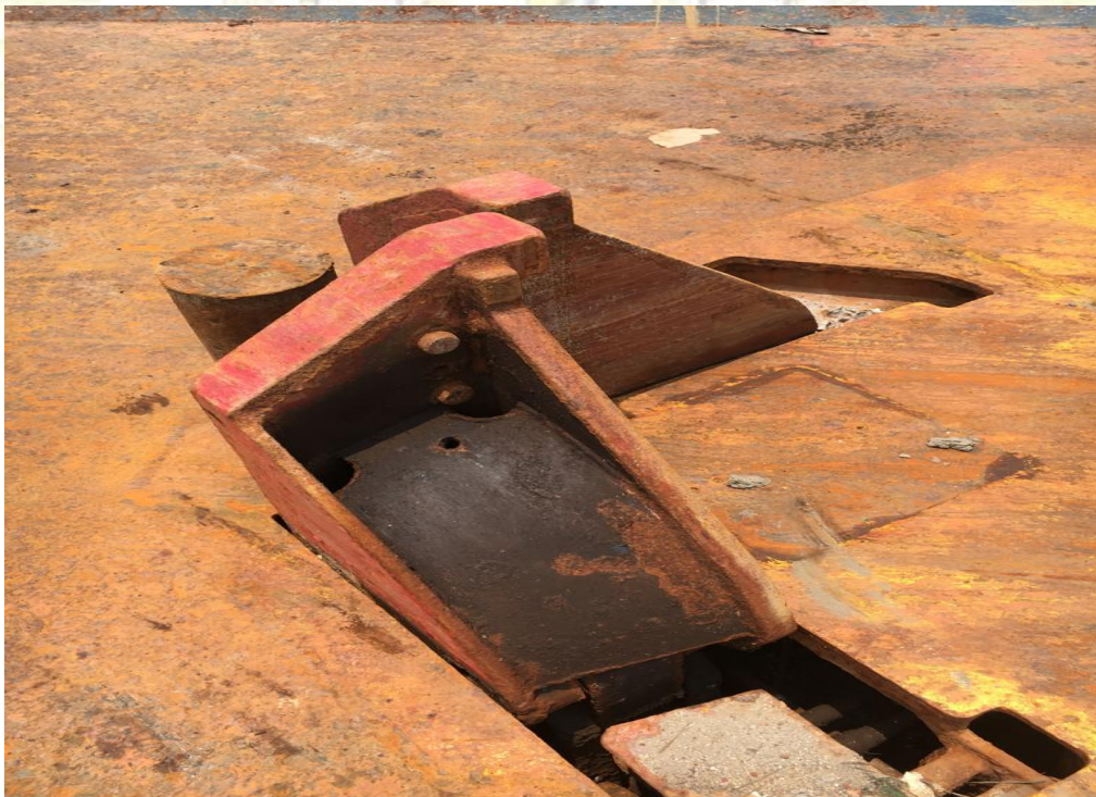
Gambar 3 : Korosi dan Lumpur di Celah Towing Pin (Sumber : Dokumentasi Pribadi)
