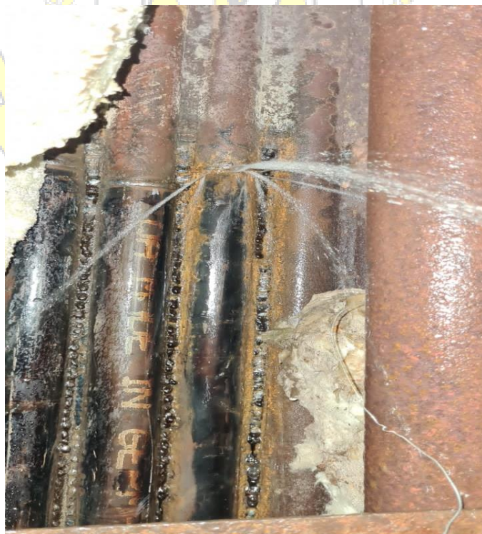
Pipa Ketika Mengalami Kebocoran
