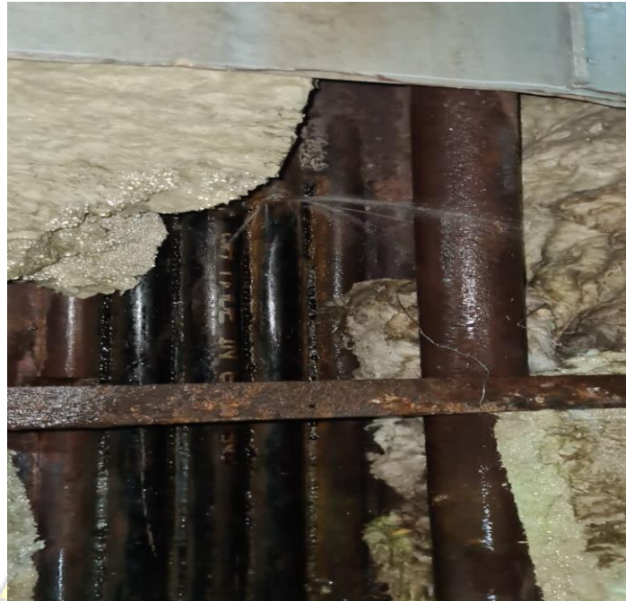
Pipa Ketika Mengalami Kebocoran
