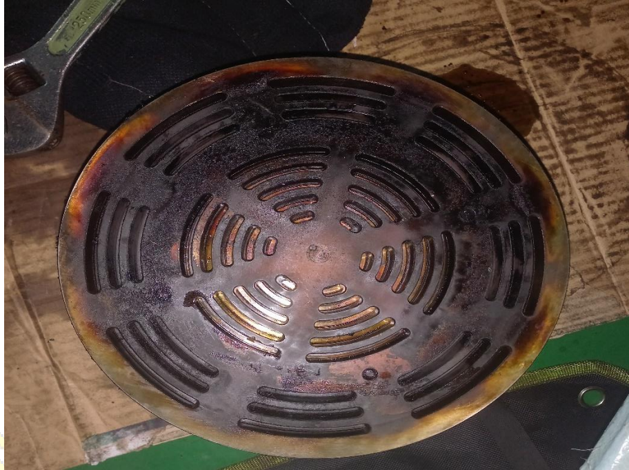
Gambar Kondisi Tersumbatnya First Stage Valve
