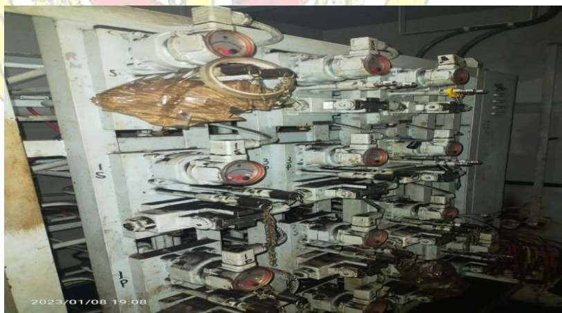
Gambar 2.3. Indikator Pompa Valve Sumber: Dokumentasi pribadi
