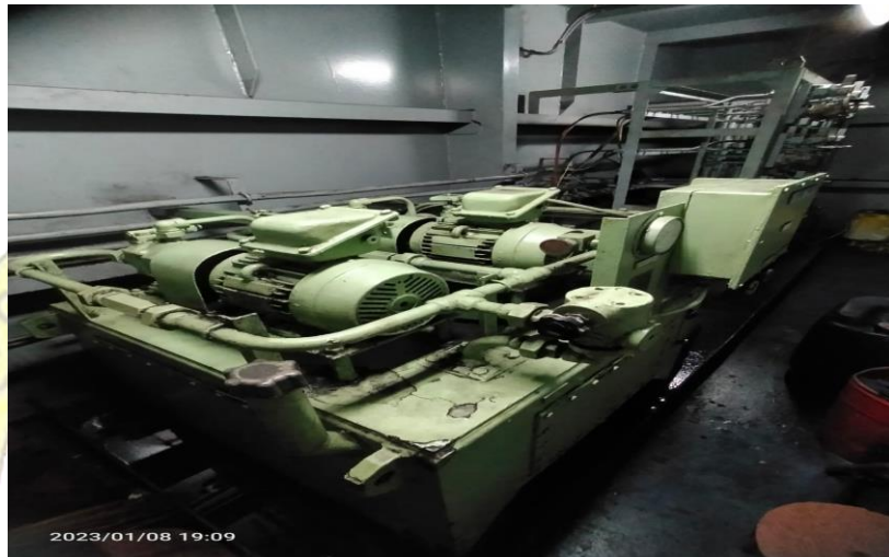
Gambar 2.2 Valve Control Room Sumber: Dokumentasi Pribadi
