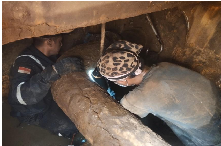
Gambar 2.5 Pipa Ballast MV DK03 Sumber: Dokumentasi Pribadi
