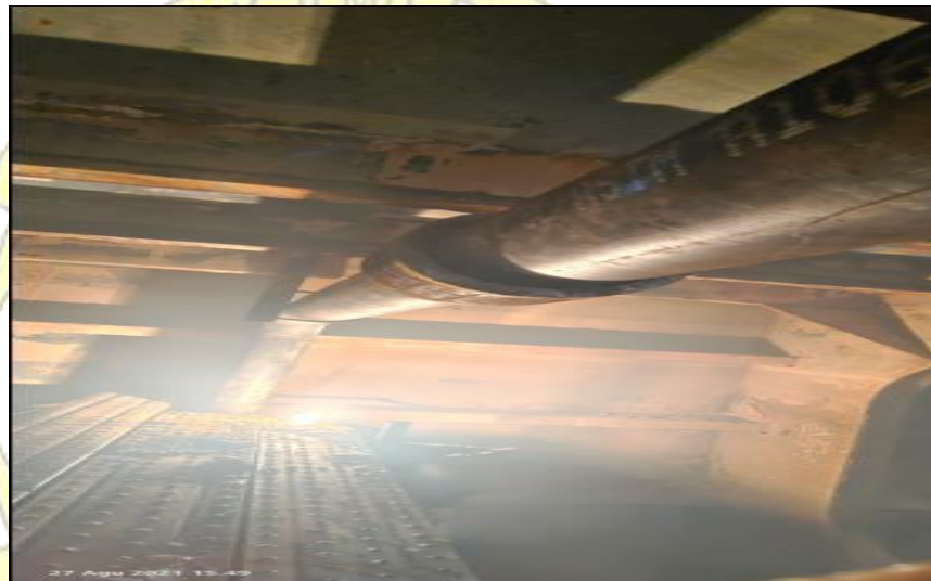
Gambar 2.4 Pipa Ballast MV DK03 Sumber: Dokumentasi Pribadi
