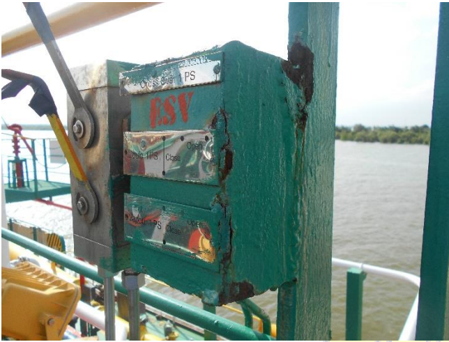
Gambar : Valve Hidrolik Liquid line dan Vapour line
