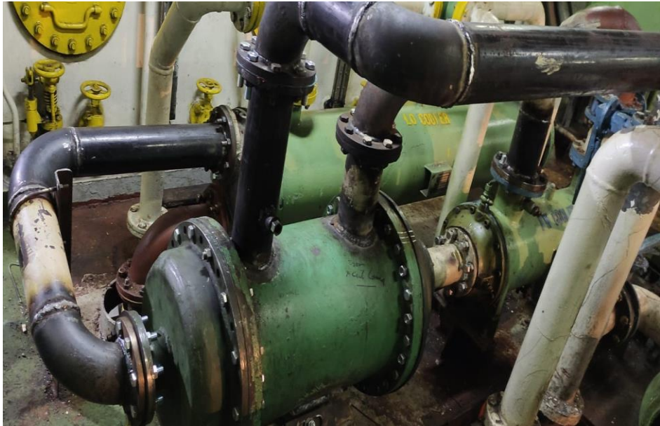
Gambar fresh water cooler tambahan setelah dipasang.
